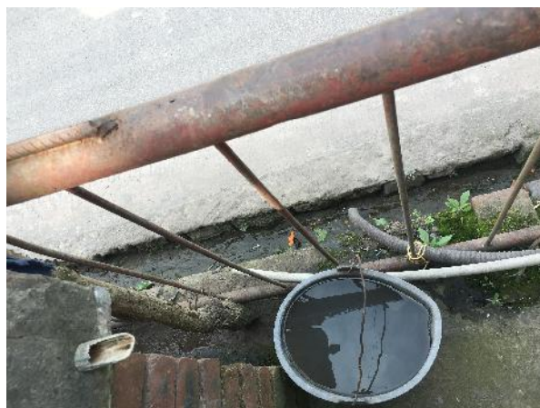
生活污水散排现状
